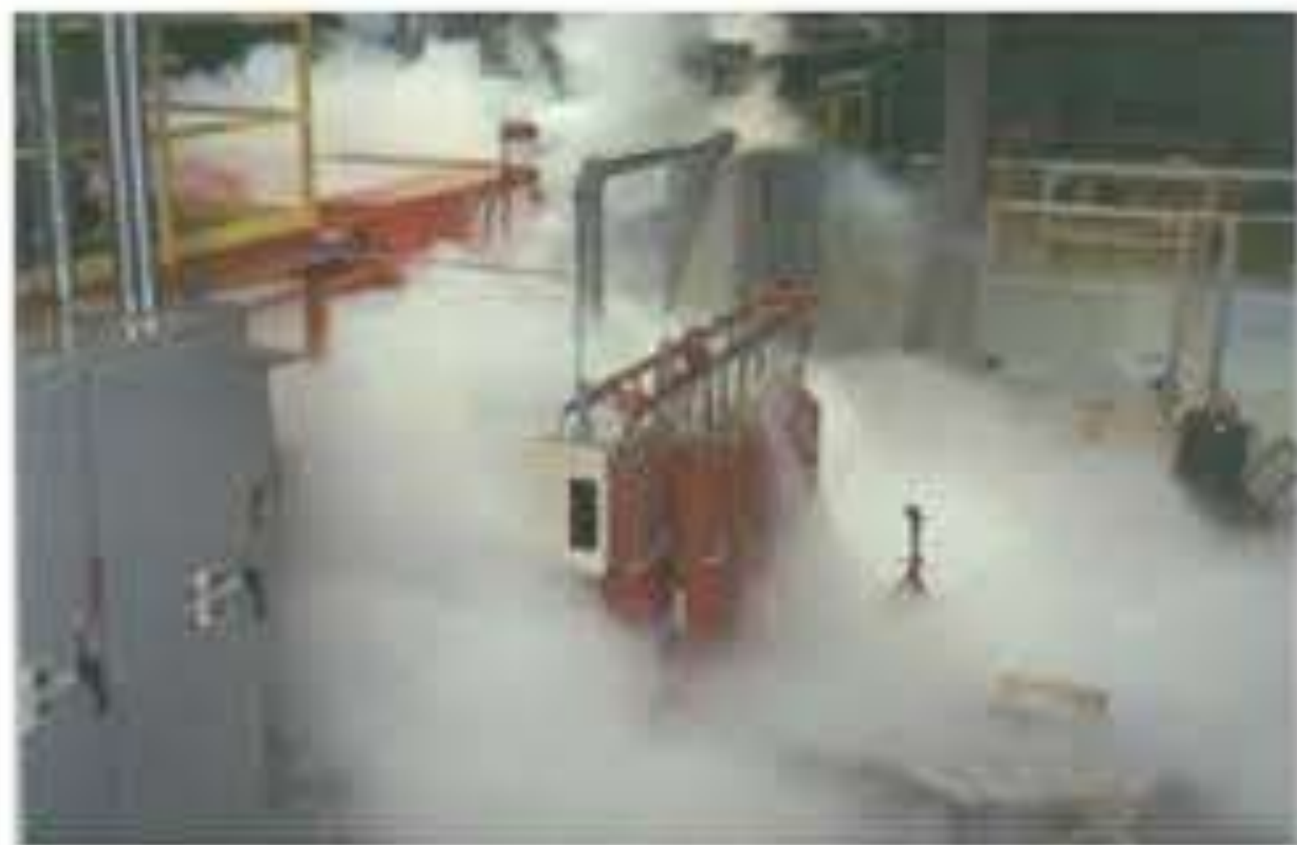
Figura 72 - Sistema de CO 2 em funcionamento
