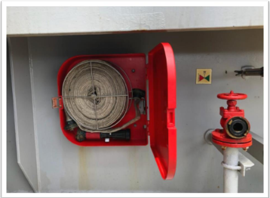
Figura 19: Posto de incêndio com mangueira, chave, esguicho e hidrante.
