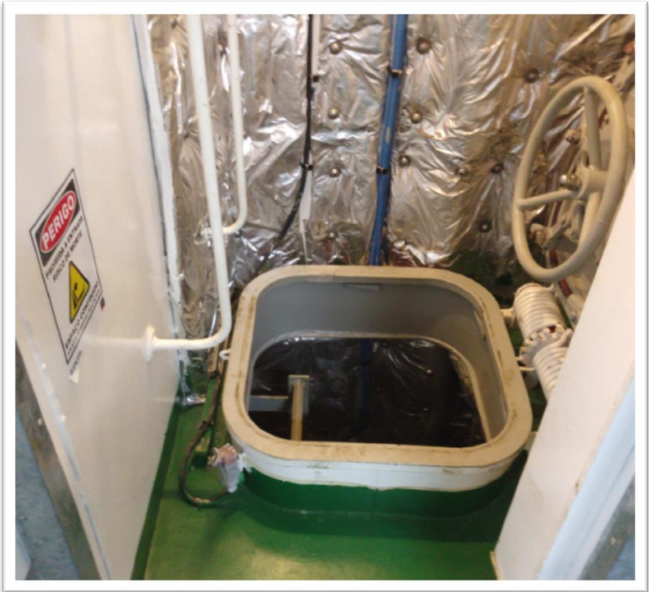
Figura 22: Agulheiro de espaço confinado. Deverá haver placas indicativos de se tratar de um espaço confinado.
