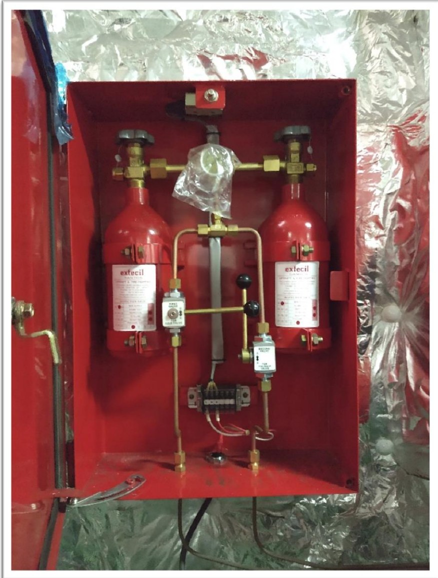
Figura 21: Cilindros-piloto do sistema fixo de Co2.
